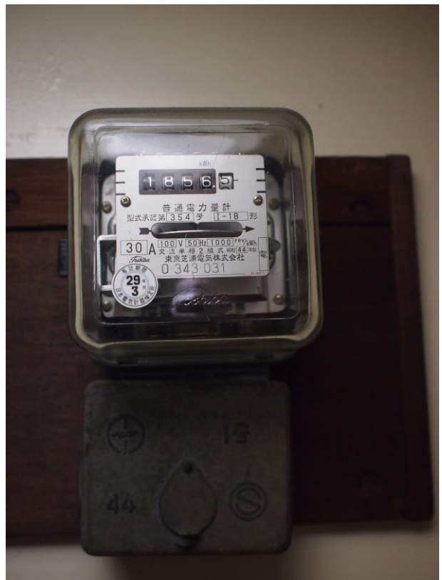
4.稼働していない電気メーター
